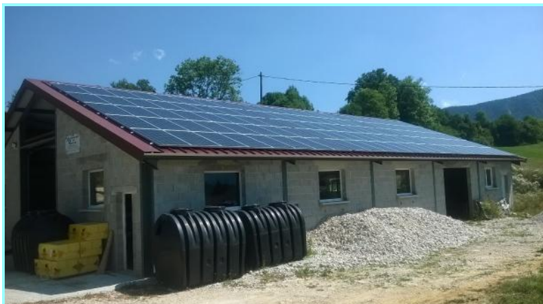
La Chapelle en Vercors -- Hangar Clet avec ses 220 m2 de panneaux en surimposés
