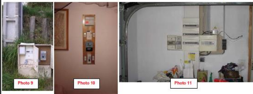
Compteur et disjoncteur dans coffrets extérieurs
